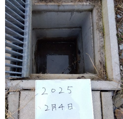
最終集水桝 (場内)
